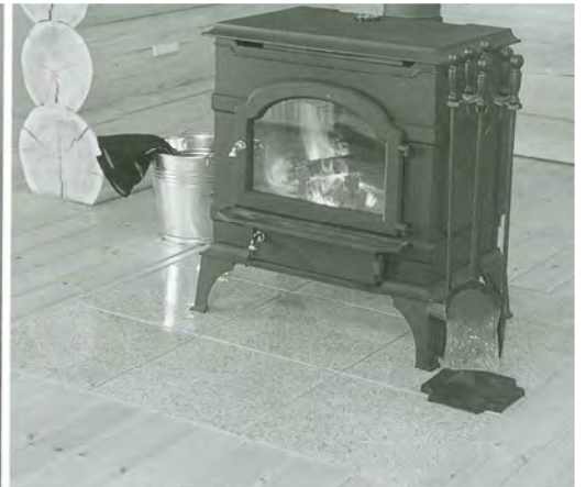
床にタイルを埋め込んで段差をなくしたモダンな炉台。薪ストーブはダッチウエストのエンライト
