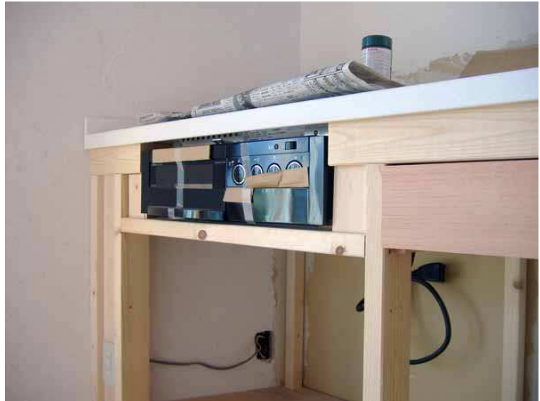
↑ 阿見邸自作キッチン IHヒーターがワークトップにセットされた (2004年)
